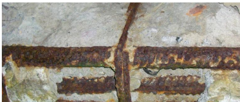
Рис. 1. Откалывание защитного слоя бетона
